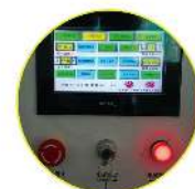
PLC控制面板 Control panel
