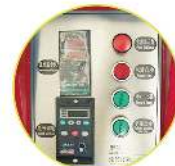
控制面板 Control panel
