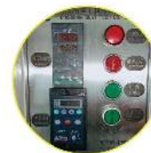
控制面板 Control panel
