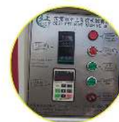
控制面板 Control panel
